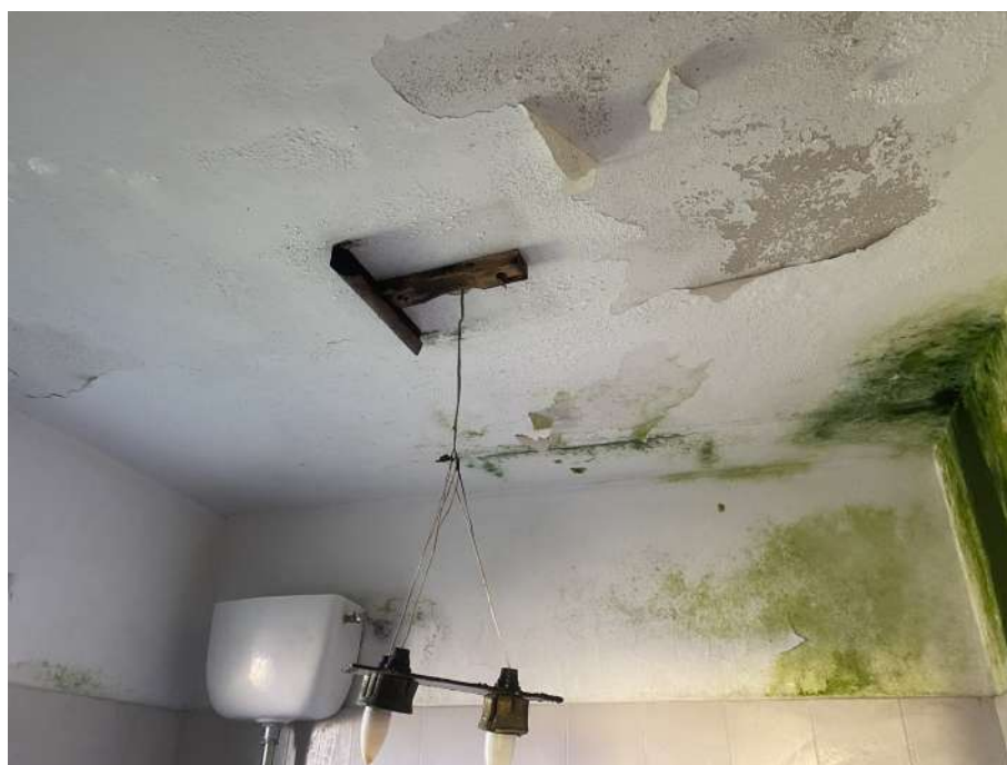
Soffitto bagno - bagnato da infiltrazioni
