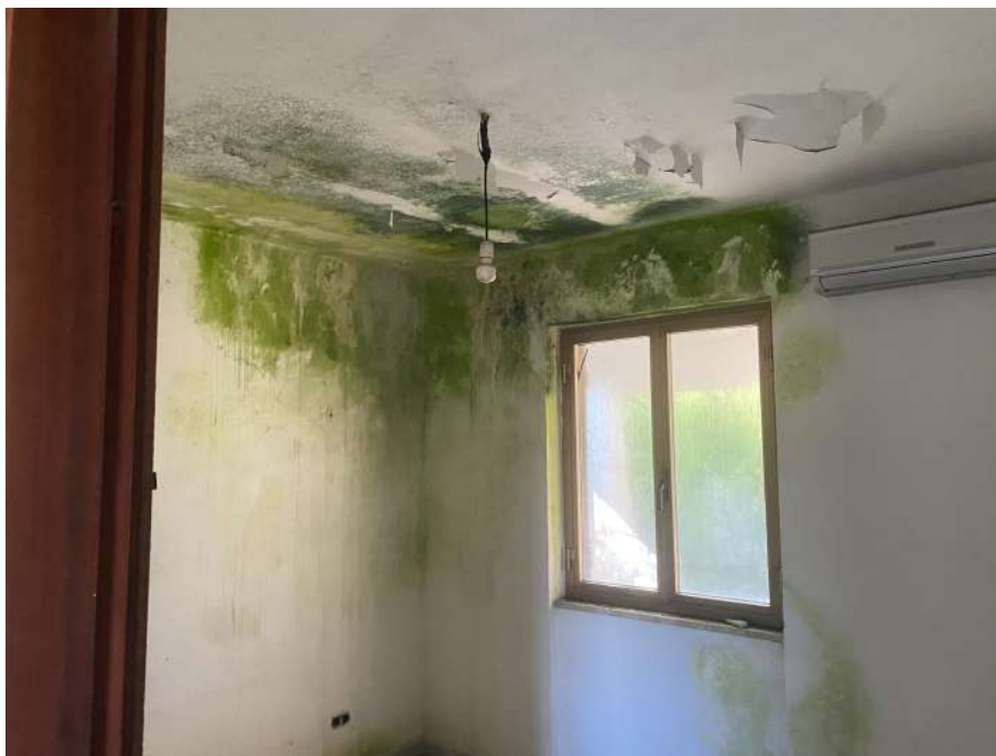
Letto- soffitto bagnato da infiltrazioni
