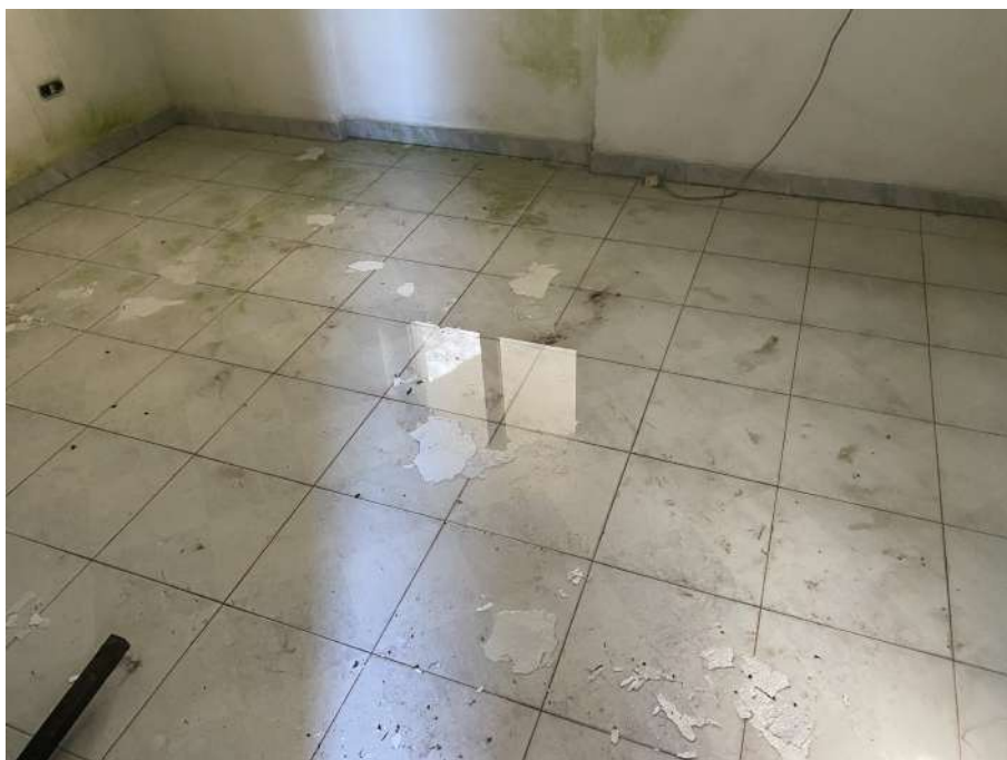
Letto – pavimento con acqua da infiltrazioni
