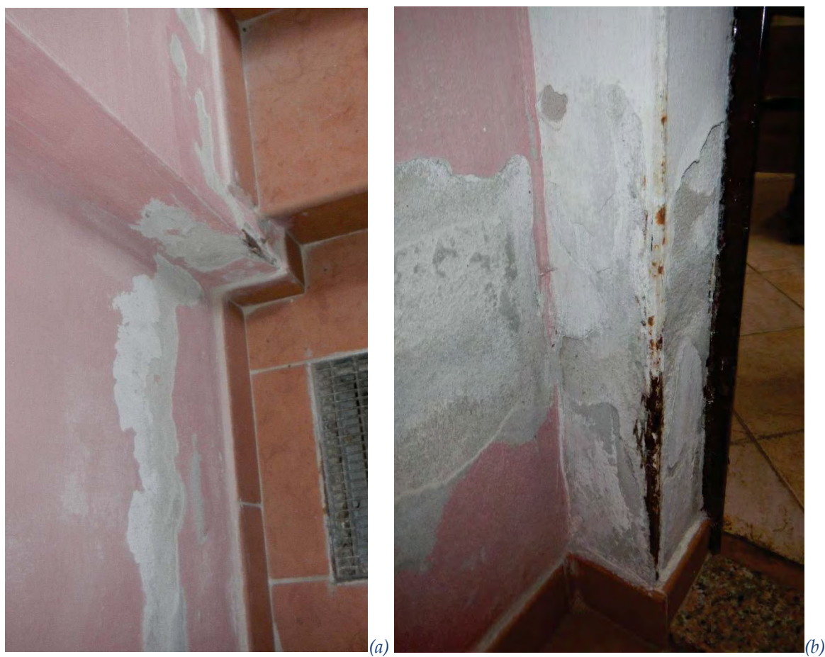
Foto 7: segni di umidità da ristagno e risalita con conseguente ammaloramento degli intonaci e dei ferri.
