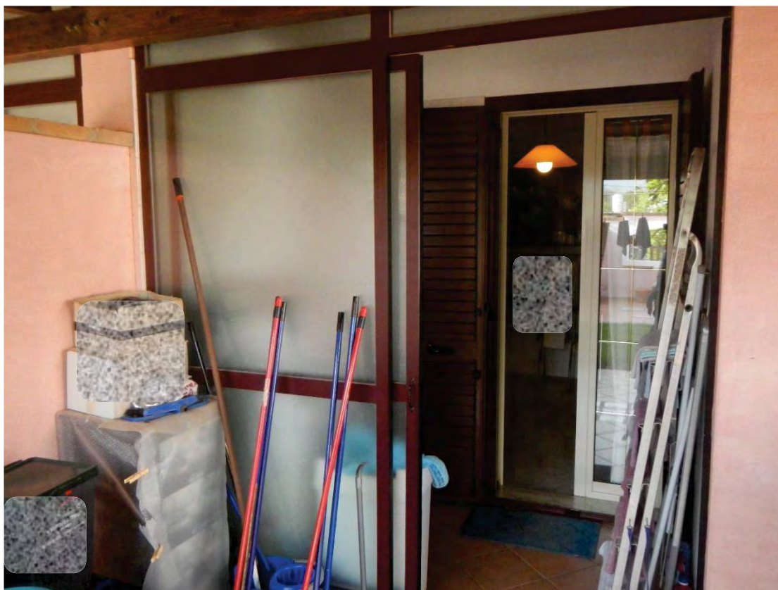
Foto 19: veranda chiusa in difformità dal titolo edilizio.
