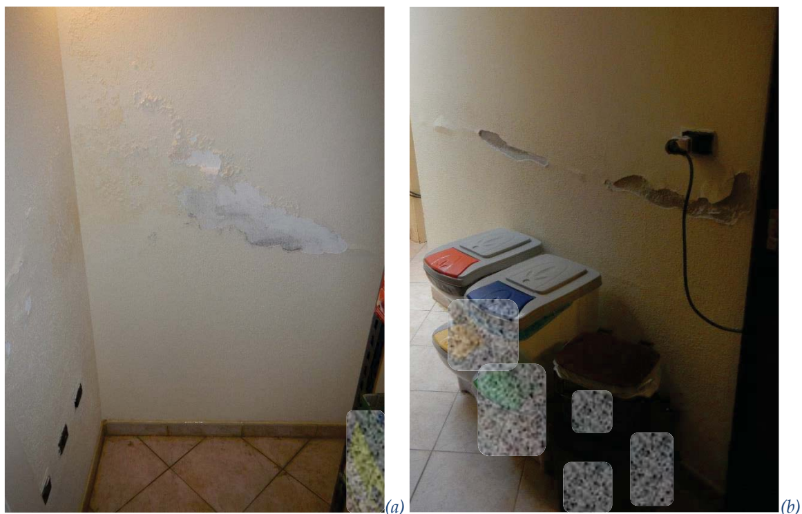
Foto 6: segni di umidità da ristagno e risalita, piano interrato.
