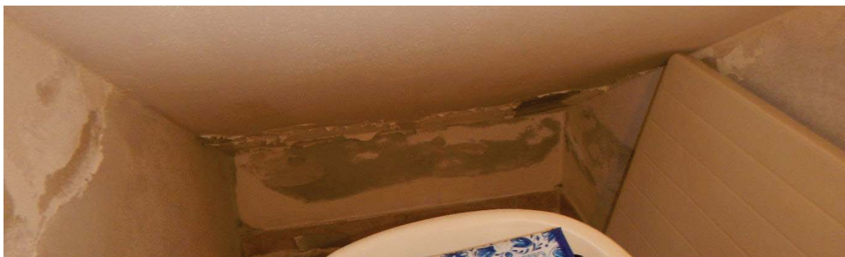
Foto 10: Segni di infiltrazione sottoscala piano interrato
