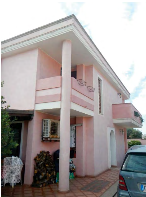
Foto 20: prospetto Nord, il balcone aggettante al piano primo si estende per circa il doppio di quanto previsto.
