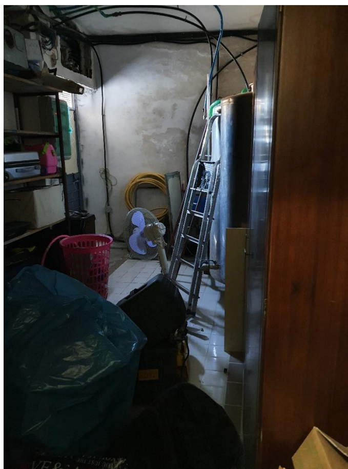
FOTO 17 (LOCALE TECNICO p.S)
