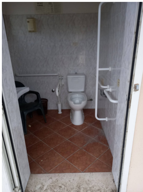
Foto 33: WC per diversamente abili
