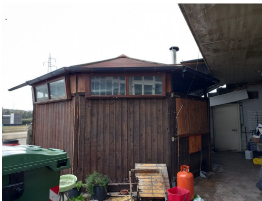
Foto 40: Deposito da rimuovere
