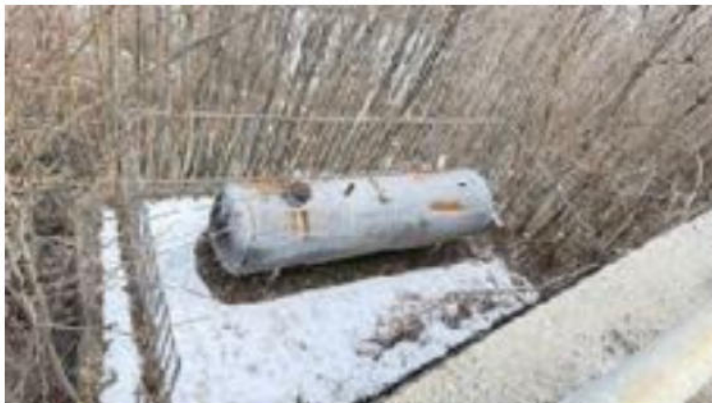
SERRBATOIO GPL COMUNE
