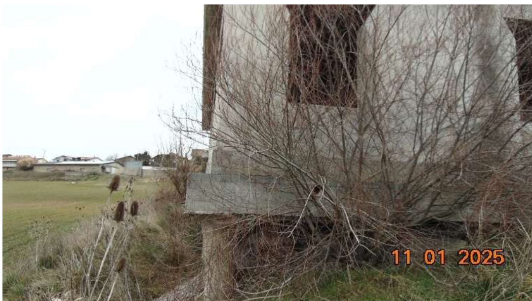
Lotto n. 4 - Foto 8 – Particolare pali e trave di fondazione
