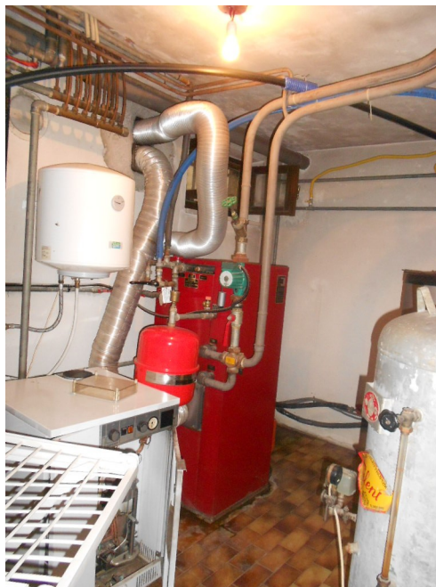
Fig. 40 vista locale caldaia
