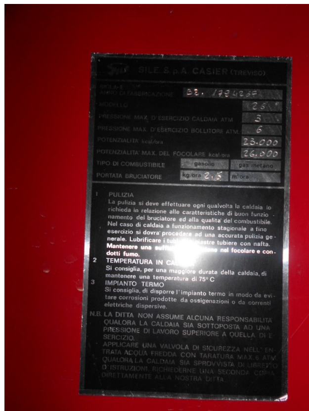
Fig. 42 Vista targhetta caldaia
