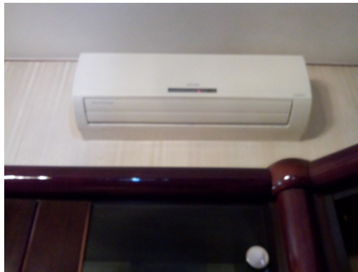
Fig. 45 Vista condizionatore nella stanza soggiorno.
