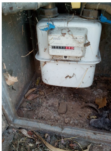
Fig. 45 Vista del misuratore del metano.
