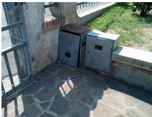
Fig. 45 Vista posizione dove alloggiato l'apparecchio misuratore del metano.
