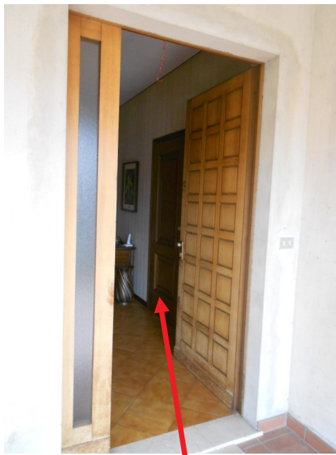
Fig. 19 Vista porta ingresso casa. Si veda la porta interna abusiva.
