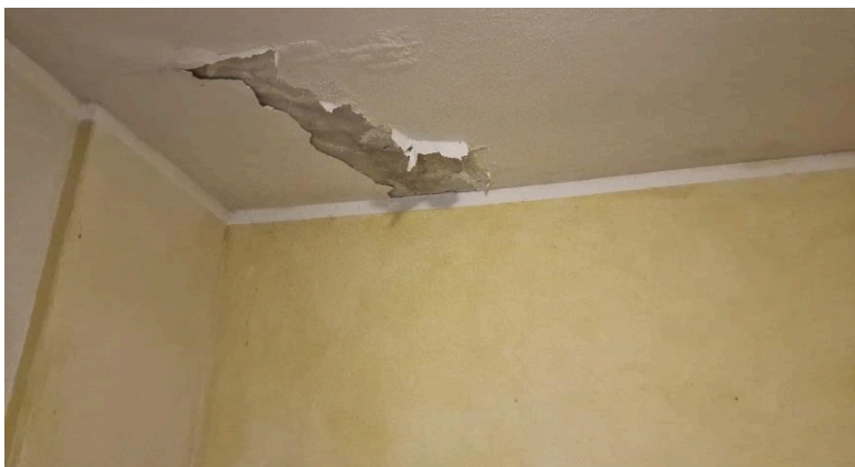
INFILTRAZIONI PRESENTI NEL LOCALE DI DEPOSITO
