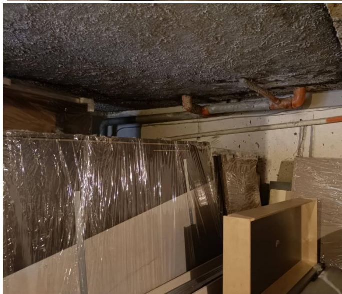
Serbatoi d'acqua e tubi di scarico presenti nel vano interrato
