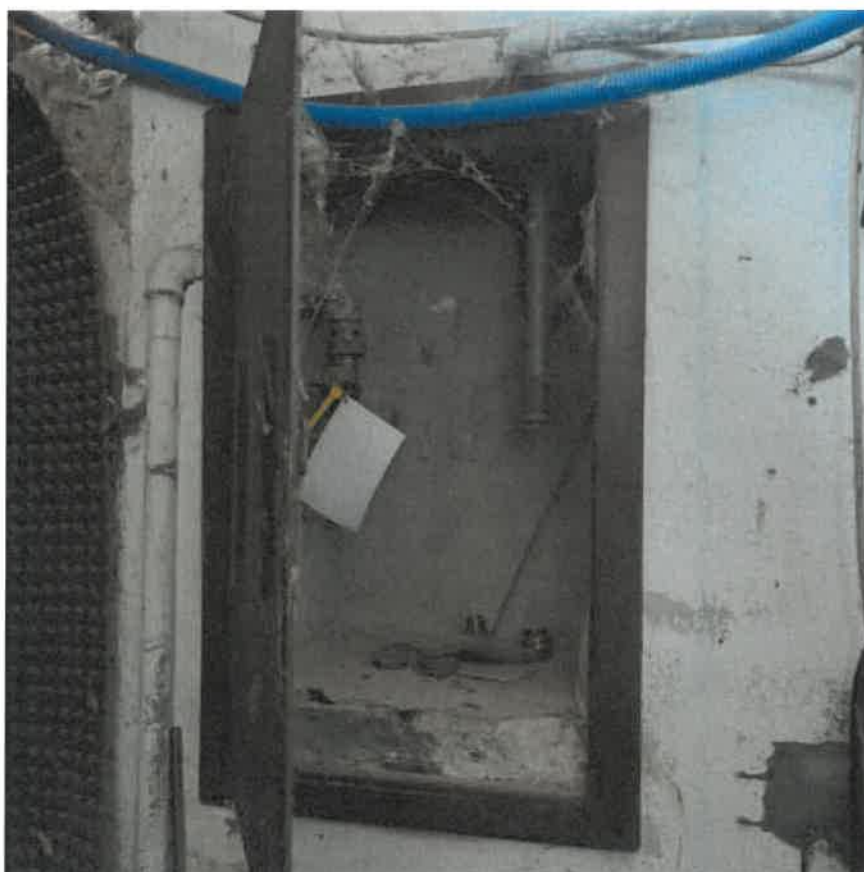
Vista particolare contatore impianto gas – metano
