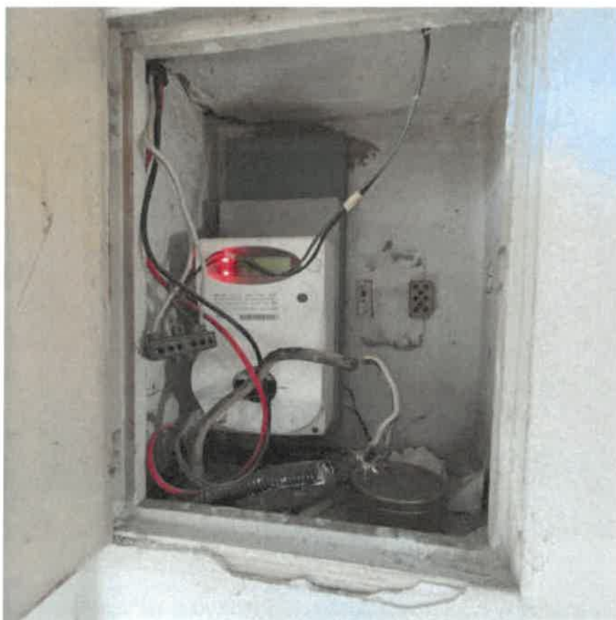
Vista particolare contatore luce – forza
