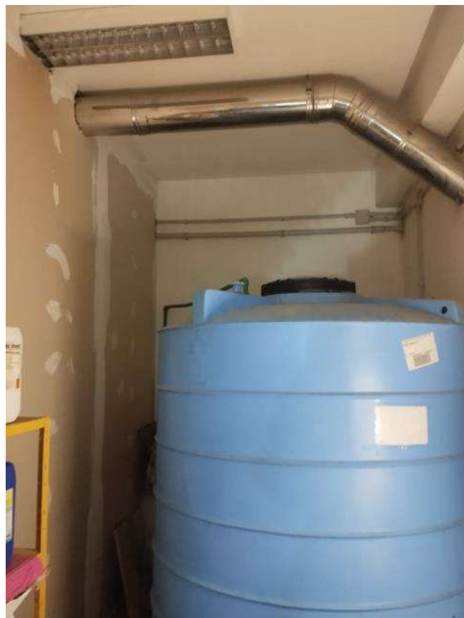
Foto 10 locale tecnico autoclave
