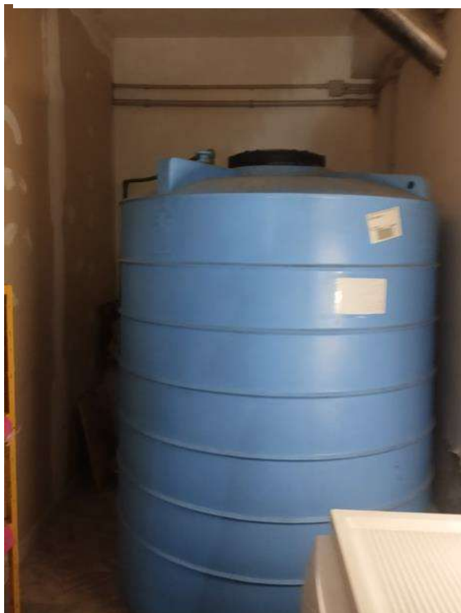
Foto 9 locale tecnico autoclave
