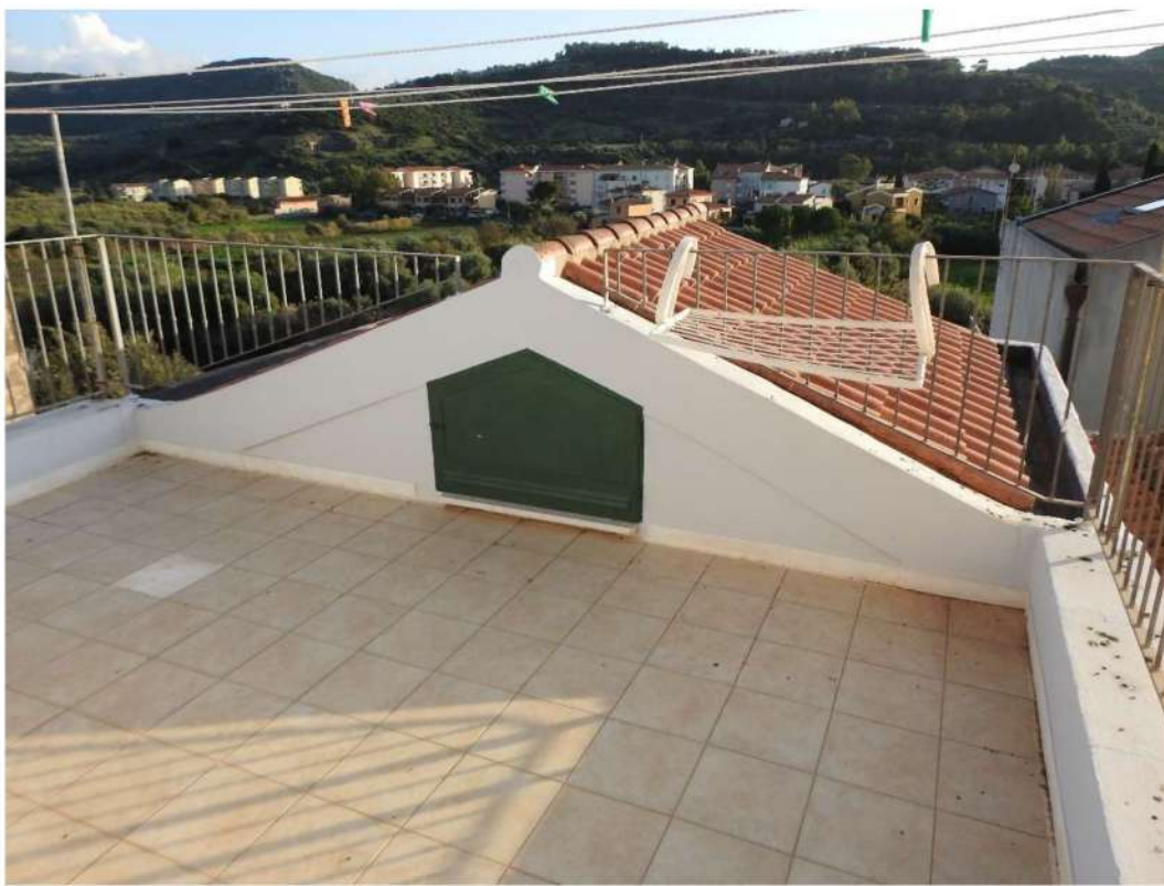
Figura 22 - Terrazza condominiale (abusiva). Visuale dalla porta finestra
