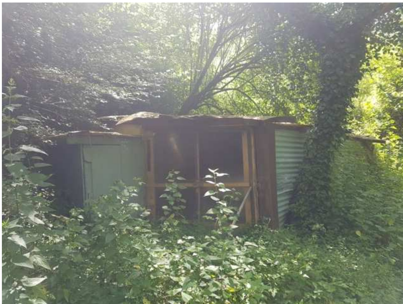
Foto n. 33 – Manufatto precario da rimuovere nel terreno
