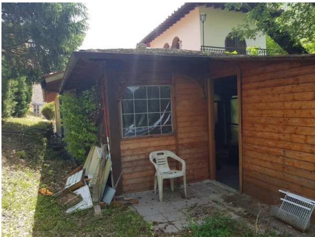
Foto n. 18 - Parte realizzata senza alcun titolo e da rimuovere
