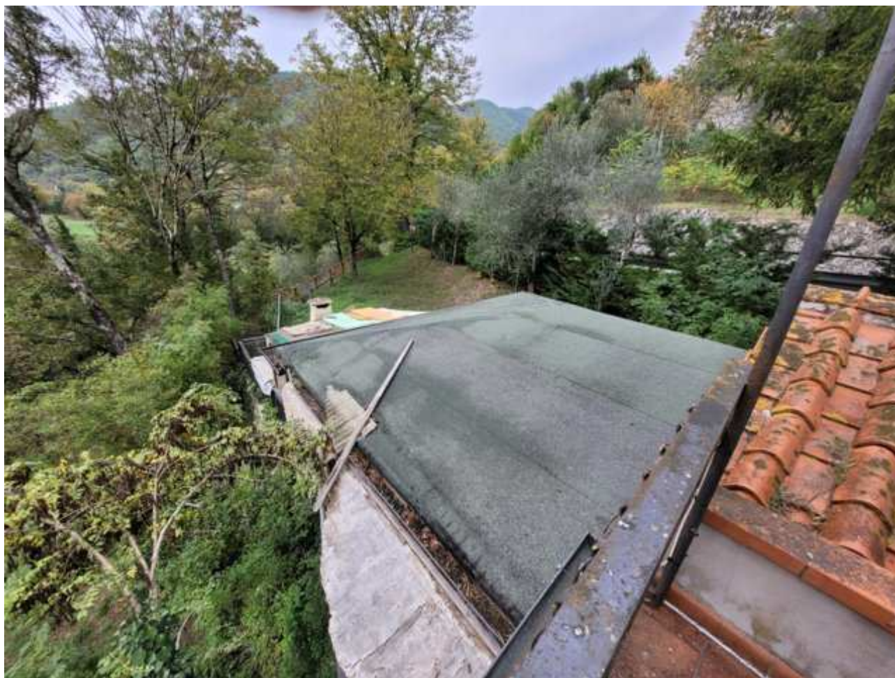
Foto n. 29 – Vista della copertura della parte costruita senza titolo da demolire
