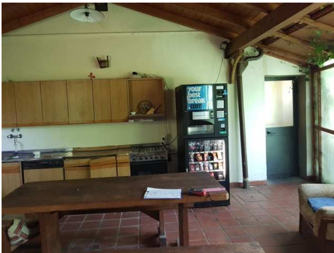
Foto n. 16 - Parte realizzata senza alcun titolo e da rimuovere
