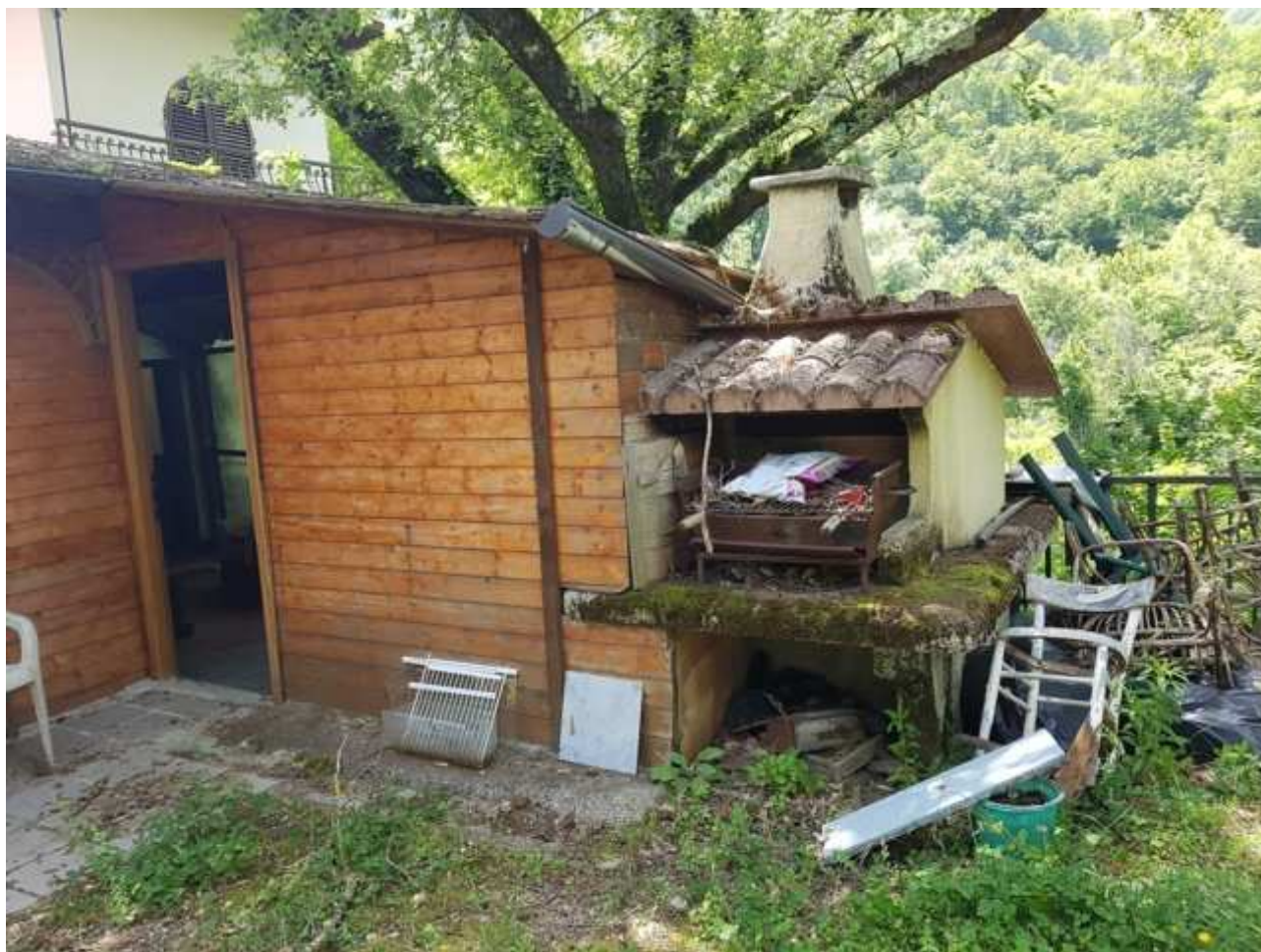
Foto n. 19 – Parte realizzata senza alcun titolo e da rimuovere
