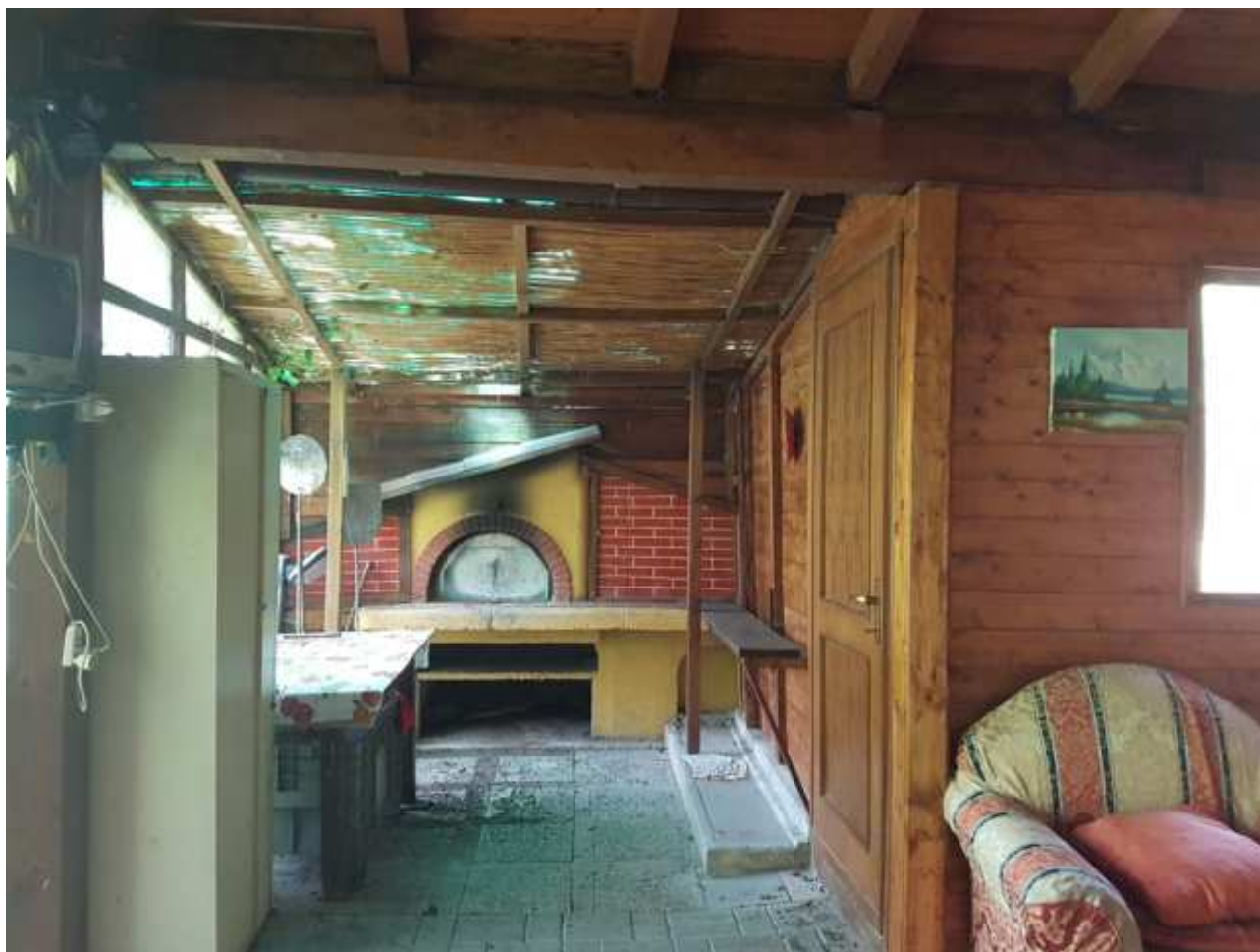
Foto n. 17 – Parte realizzata senza alcun titolo e da rimuovere
