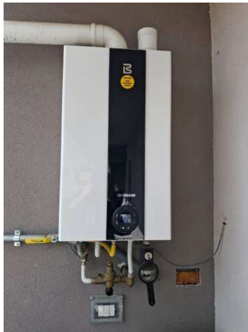
Caldia per riscaldamento
