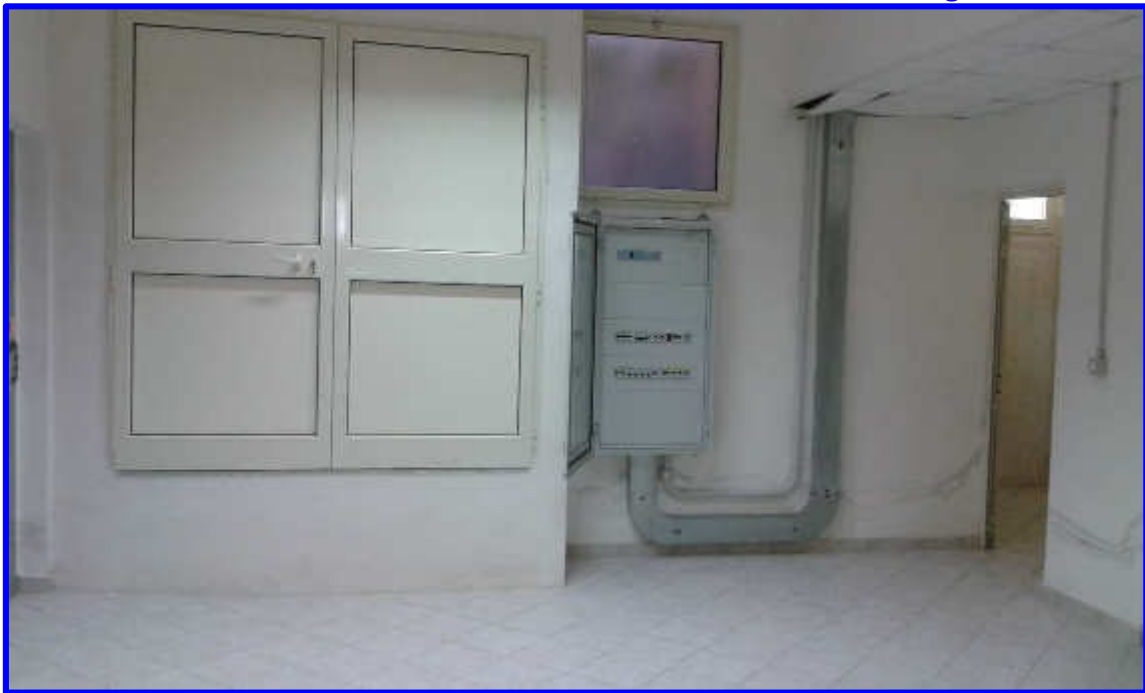
Particolare del vano contatori e quadro elettrico
