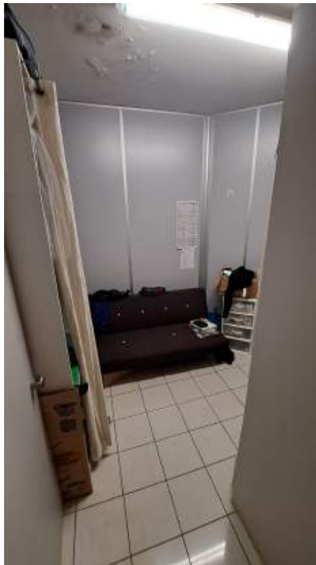
Veduta infiltrazioni acque meteoriche nella zona condominiale e all'interno del subalterno
