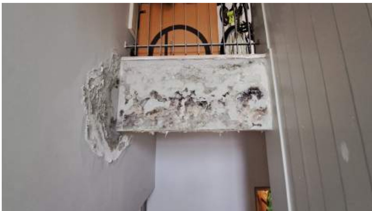
Veduta infiltrazioni acque meteoriche nella zona condominiale e all'interno del subalterno
